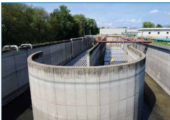
Figura 8 – La conformazione a canale delle vasche di trattamento ha costretto i tecnici di Xylem ad un accurato lavoro di progettazione per individuare i parametri di funzionamento ottimali.
